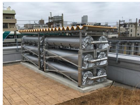
江戸川中央店設置予定の非常用貯水機能付給水管「マルチアクア」（写真は墨田吾妻橋店）
